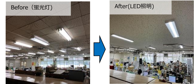
施設構内の照明のLED化
