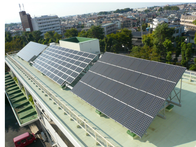
キャンパス内の太陽光発電設備
